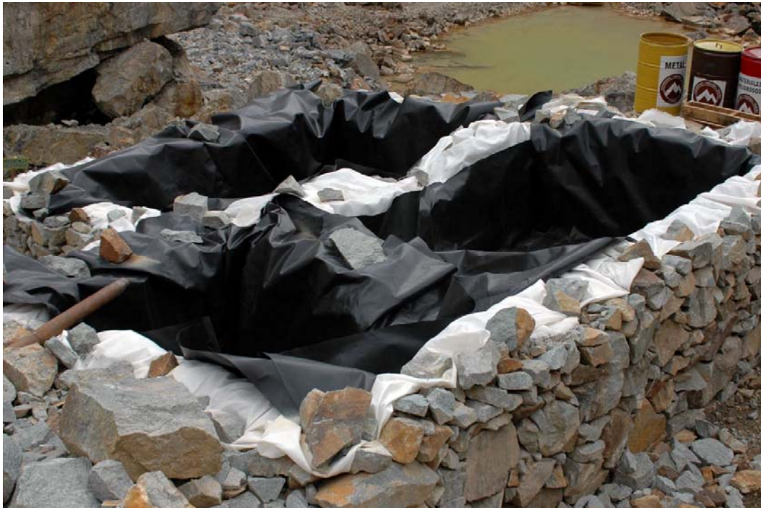
FOTO 8: Las pozas de lodo con membrana impermeable
